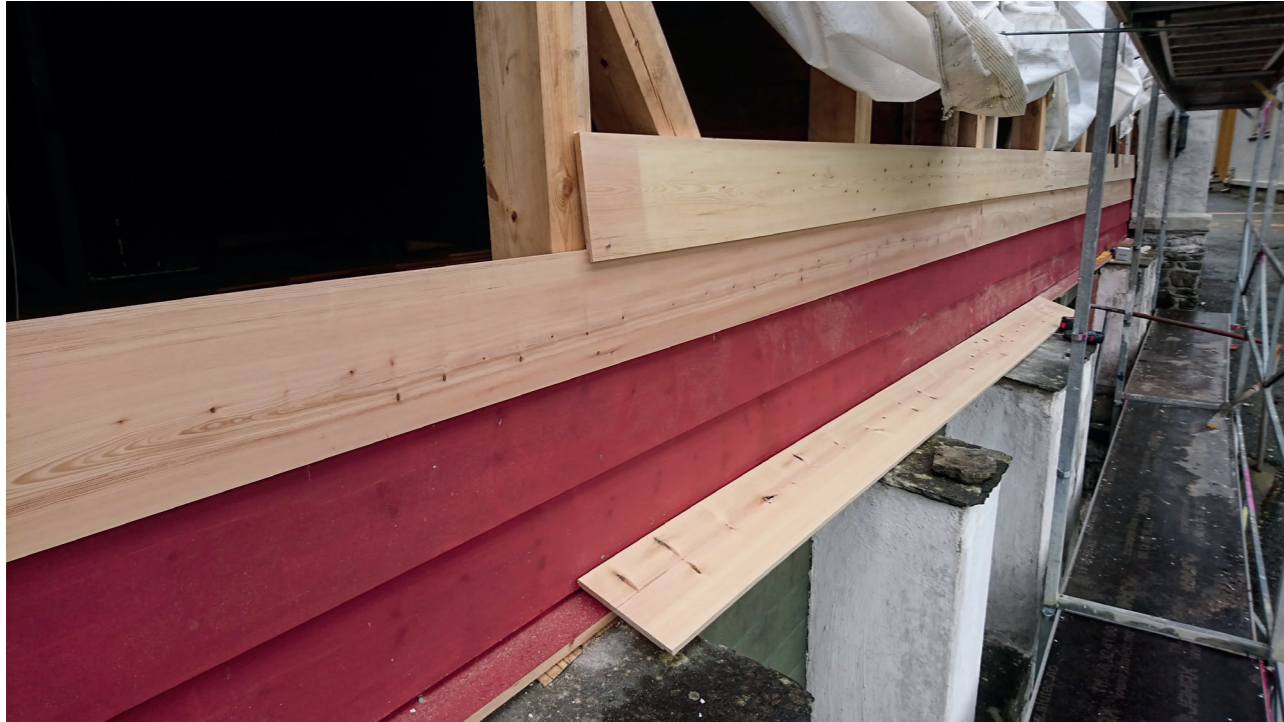
Rulleboden, Salhus, Norsk Trikotasjemuseum, Museumssenteret i Hordaland. Panelet på vestveggen ble skiftet høsten 2017.
