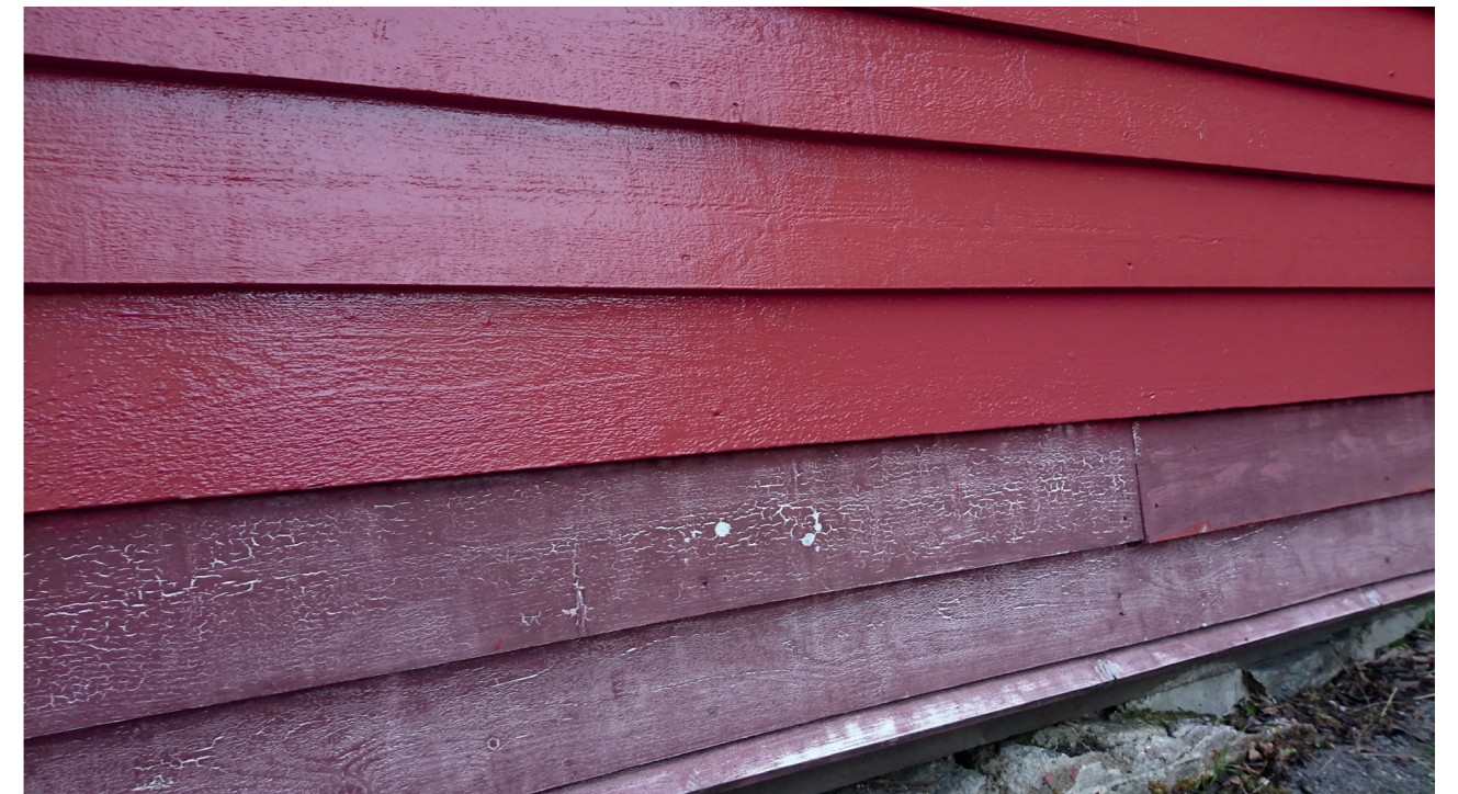
Maling før og etter – Rulleboden, Salhus, Norsk Trikotasjemuseum, Museumssenteret i Hordaland. Rulleboden er fra 1865. Panelet på vestveggen ble skiftet høsten 2017. Bygningen er malt med linoljemaling.
