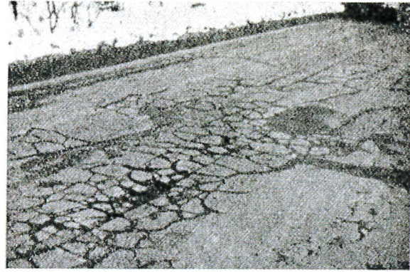
Fig. 2. Beläggning av asfaltbetong efter tjällossningen våren 1933 från stockholmstrakten.
