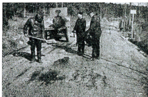
Fig. 4. Lagning av sår på vägbanan, orsakad av „tjällskott”. April 1933.
