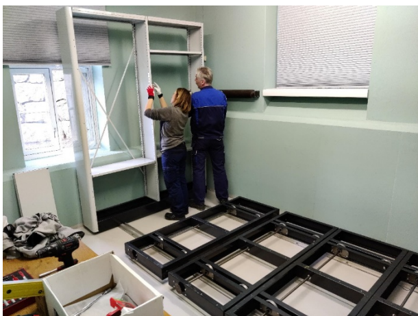
Montering av rullearkiv i fotoarkivet. Rullearkivet er gjenbruk frå eit ombyggingsprosjekt på Eitrheim i Odda. Foto: Dag Endre Opedal/Kraftmuseet
