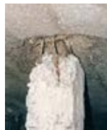
Det kunne bli levert mangelfull kvalitet – som byggherren hadde akseptert. Her fra en blokk i Oslo. (Foto: Elisabeth Schjøberg)
