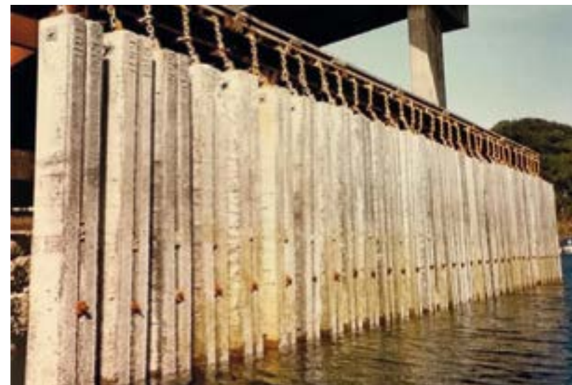
Som del av Kystbruprojektet ble bjelkeelementer i 1991 koplet sammen og hengt opp under en nedlagt kai ved Sandnessjøen. Elementene er satt i spenn med en mellomliggende kloss. (Foto: Hilde Rannem Isaksen)
