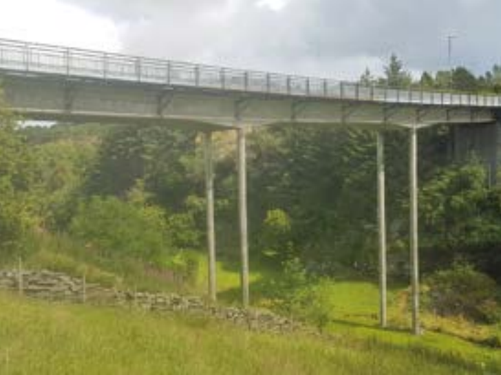
Reduksjon av kostnader har alltid vært i fokus når samferdselsprosjekter skal bygges, og i en periode resulterte det i nokså slanke konstruksjoner, også bruer – som Dale bru i Hordaland fra 1956. (Foto fra Vegvesenets bruregister Brutus)
