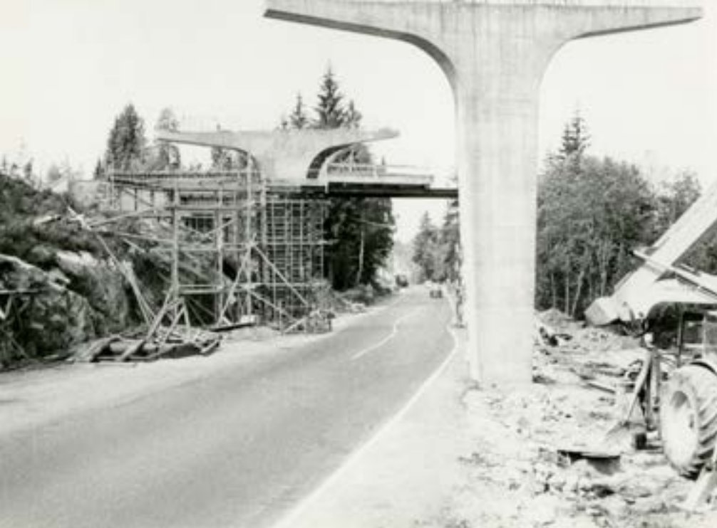
I Akershus ble det bygd ny E18 mellom Vinterbro og Mastemyr (Oslo grense) til avløsning av den gamle Mossevegen. Her er Ringnes bru under bygging i juni 1969.
