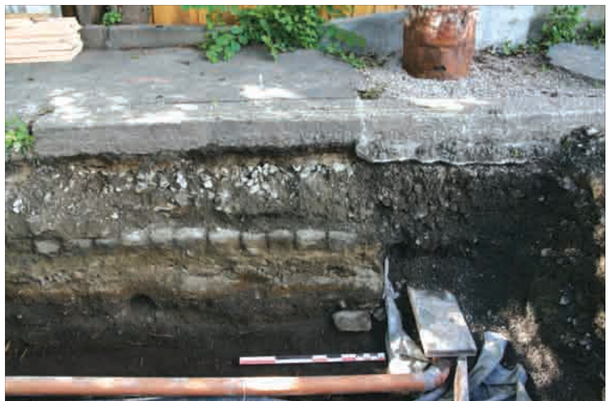
Graving av vann- og avløpsledning gjennom middelalderkulturlag uten tillatelse (Foto: Norsk institutt for kulturminneforskning 2010).
