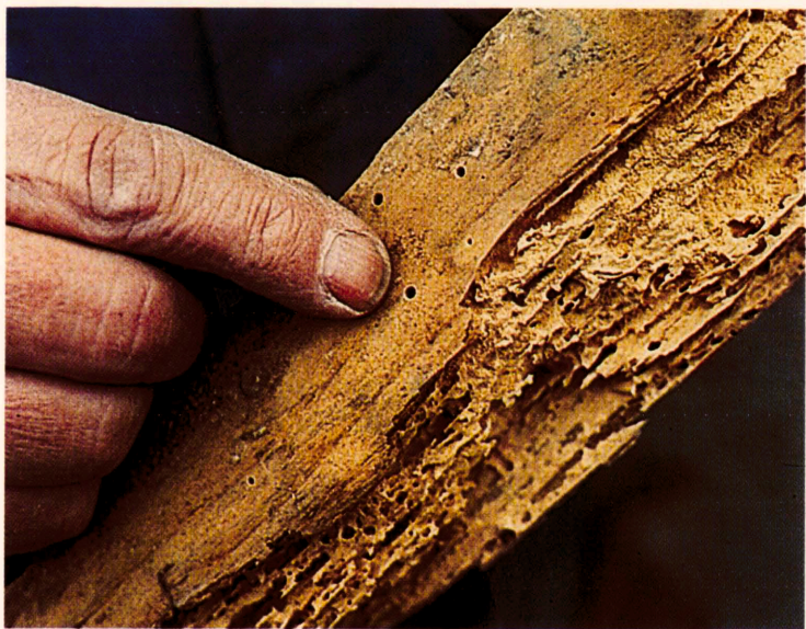
Rötskadat trä med angrepp av envis trägnagare.
