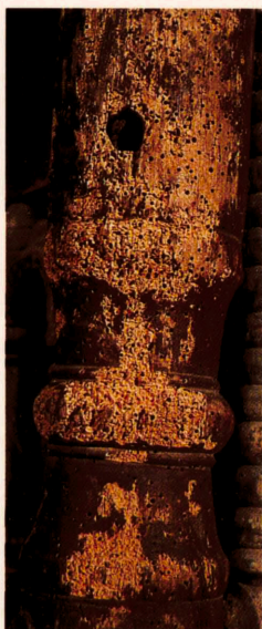
Massivt angrepp av trägnagare.
