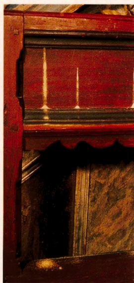
Ränderna och högarna av borrmjöl visar att stolen har ett aktivt trägnagarangrepp.
