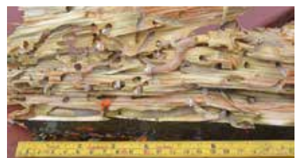
Stråkjølen til «Den Siste Viking II» var ny sist vår. Her har pælemarken gjort en grundig jobb på bare noen måneder! Heldigvis har vi takpapp mellom kjølen og stråkjølen, så det er bare stråkjølen som er berørt. Foto: Einar Borgfjord.
