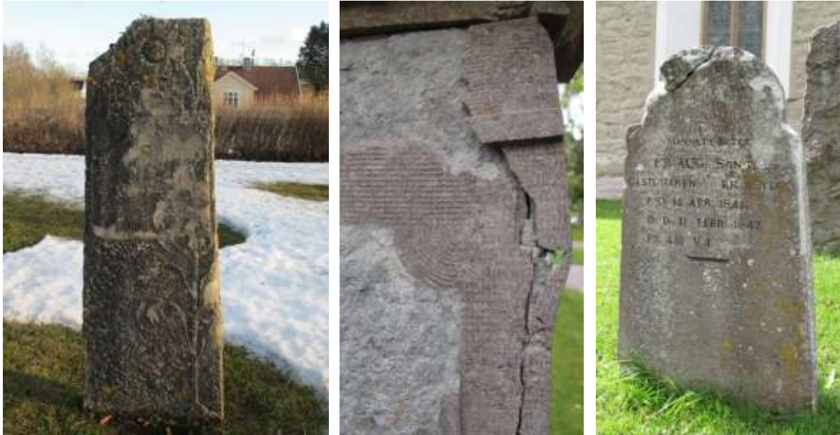
Bilderna ovan visar på olika skador som flera av gravvårdar av kalksten har. Vittring, skador efter frostsprängning, sprickor m.m.
