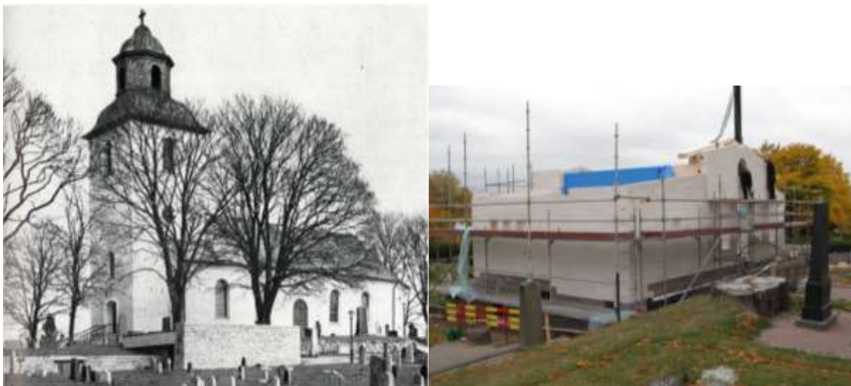
Kyrkan med det gravkapell som uppfördes år 1957. Källa: Samzelius, N. (1961) En krönika om Hallsberg . Ny bisättningsbyggnad under uppförande, oktober 2013.
