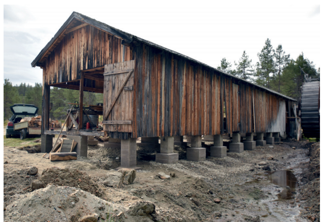
Vassaga. Store reparasjoner ble gjort på fundamentene til Vassaga i Folldal. Foto: Torgeir Ren-nemo
